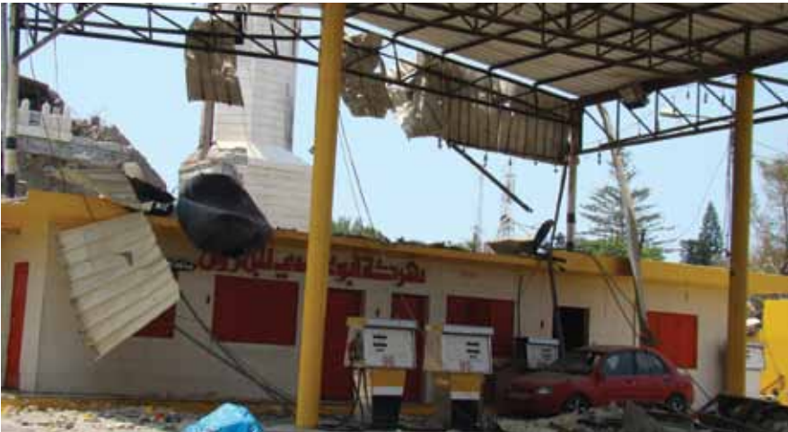
آثار الدمار الذي حل بمحطة أبو عاصي للبتزول جراء القصف الإسرائيلي للمسجد المجاور في شارع الوحدة بمدينة غزة
