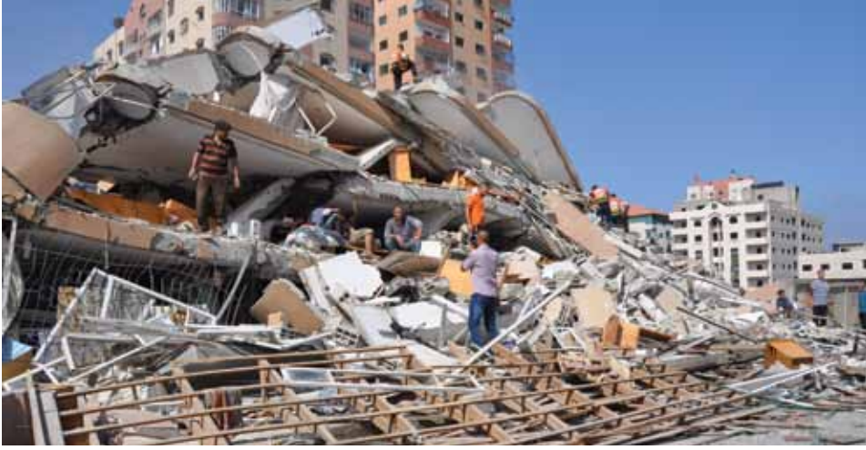
بقايا برج الظافر (٤) الذي دمرته قوات الاحتلال في مدينة غزة
